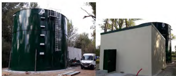
Réservoir provisoire et son local technique, champ captant de Labadier.
