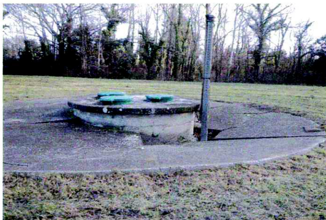
Figure 4 : Puits n° P1 avec margelle affaissée
